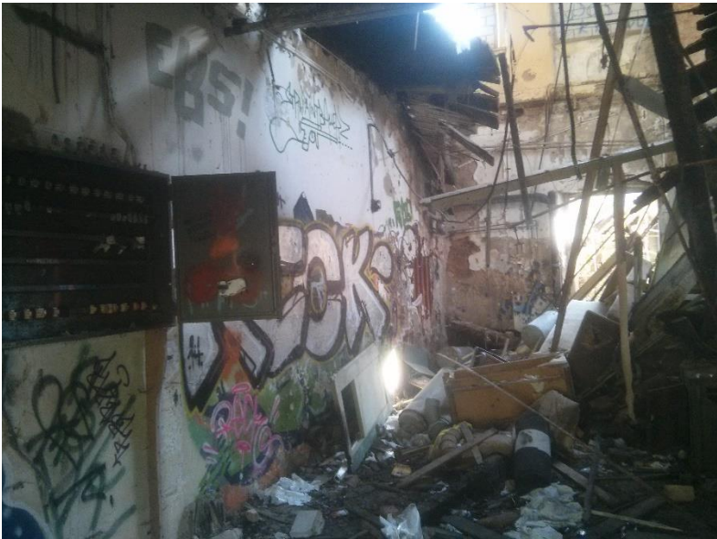
Bild 3-6, Abfallberge und Bauschutt:
