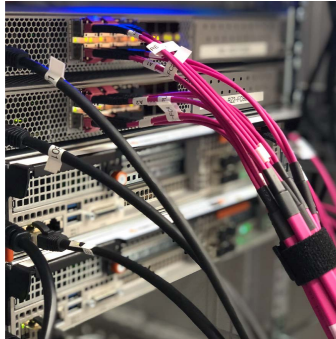
39 Server im Rechenzentrum
