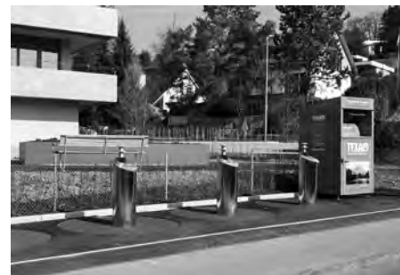
Unterflursammelstelle «Untere Gstückstrasse».
