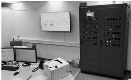
Auf dem neuesten Stand der Technik: die Wasserbetriebswarte.
