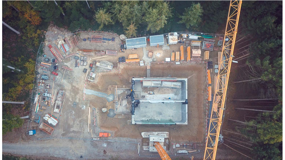
44 Luftaufnahme Baustelle Reservoir Neubruch. Deutlich zu erkennen die beiden Wasserkammern mit einem Inhalt von 2 x 450m 3 oder 2 x 450 000 Liter.
